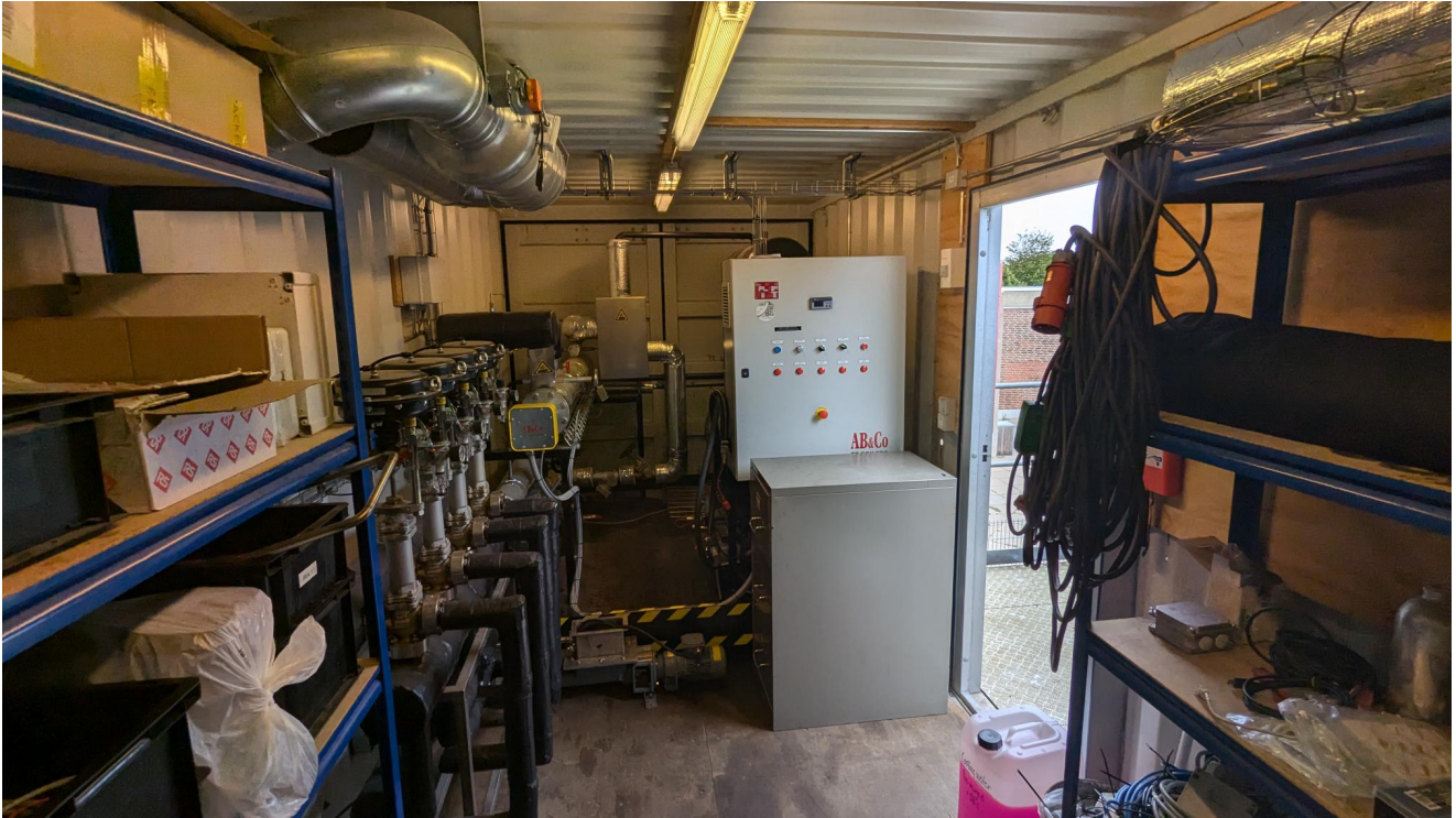
Container 5: Heating-oil anlæg til separationssystem. Elektrisk olieheater samt styretavler.
