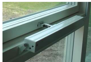
Automatisk åbning af vinduer, styret med motor monteret i vinduet
